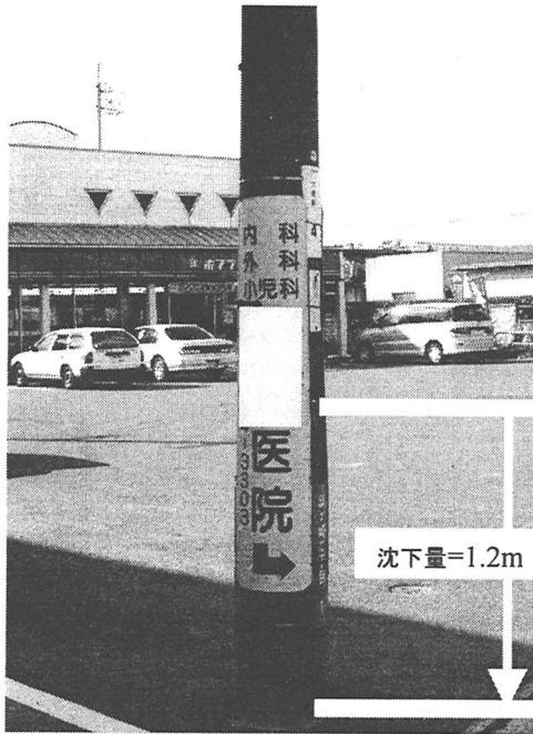
写真-2 配電柱の沈下 (米子市旗ヶ崎)
