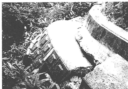
写真-1 黒坂線(66kV)No.50基礎部の被害(写真:中国電力提供)
