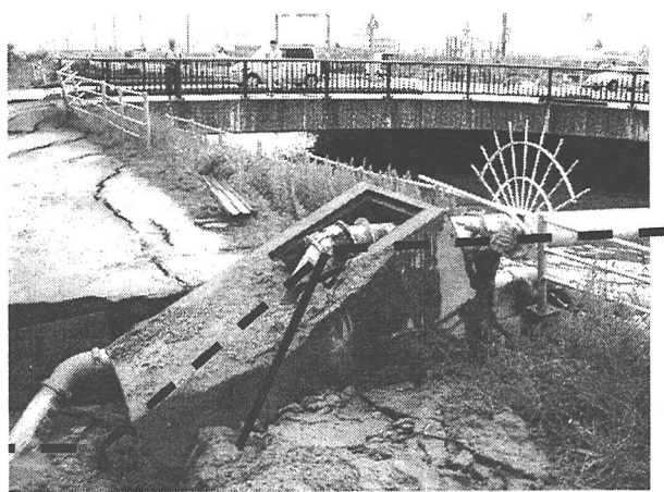
写真-4 水管橋取付部分の転倒によって生じた損壊（写真提供：米子市水道局）
