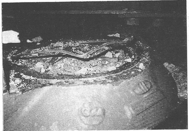
写真-4 ベアリングプレートの抜け出し
