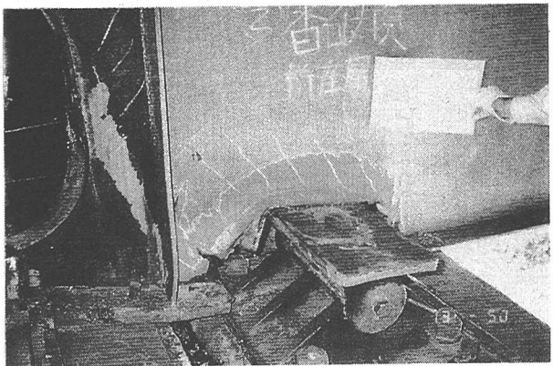
写真-6 支承による上部構造の被害
