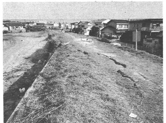
写真-4 レベル2の被害例(明石市)
