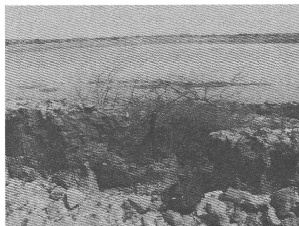
写真-11 法面に生じたクラック
