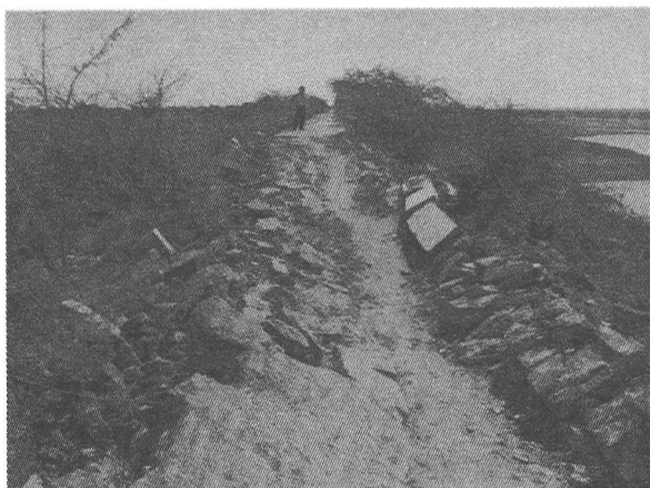
写真-9 堤頂部の沈下
