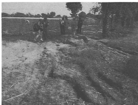
写真-1 畑の中に生じているクラック
