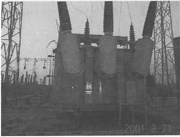
写真-16 レールから脱輪した変電設備
