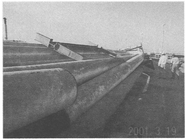
写真-14 鋼製架構から崩れ落ちたパイプライン
