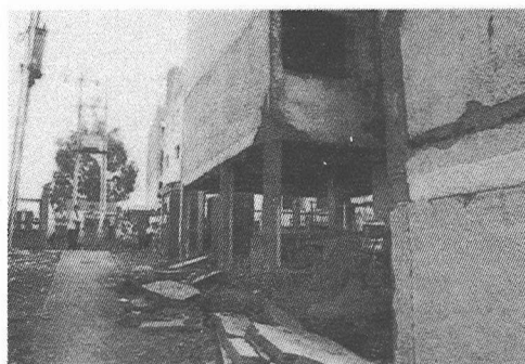
写真-2 南部の集合住宅の被害 非構造壁の破壊、柱梁接合部の損傷
