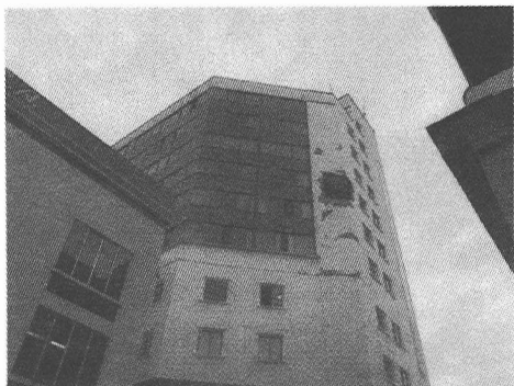
写真-3 中心街ビルの被害 非構造壁の落下
