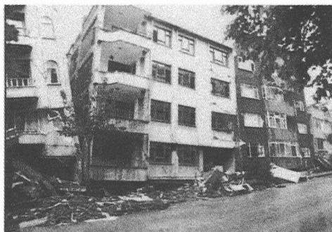
写真-9 1階層崩壊
