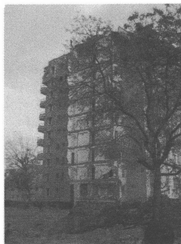
写真-5 建物の手前部分（白い部分）が完全に崩壊した集合住宅（1階がピロティ形式）
