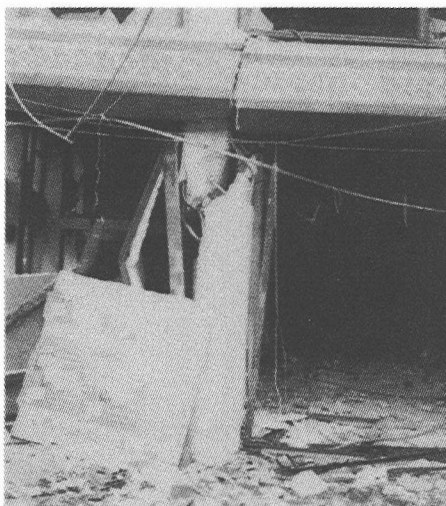
写真-10 扁平柱のせん断破壊
