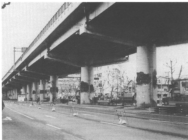
写真-1 損傷事例
