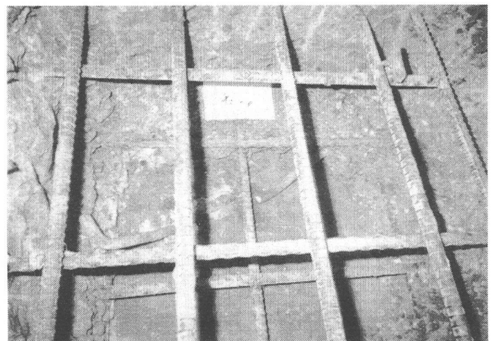
写真-6 P214~P215 G2桁上スラブ止め破断
