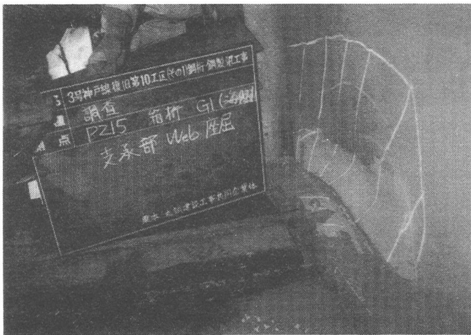
写真-1 P215 G1 (海側) 支点部腹板座屈
