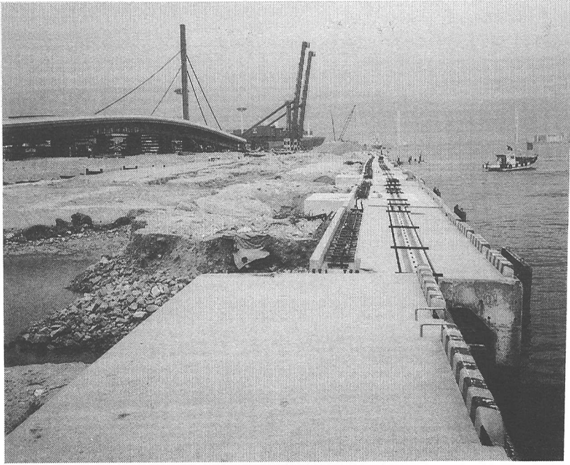
(写真-1) 被災全景
