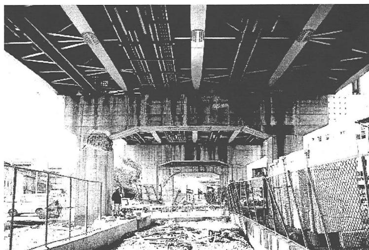
写真-1 鉄筋コンクリートラーメン橋脚の被災事例（1）
