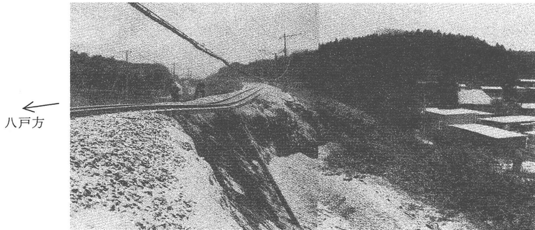
写真1 被害状況 (東北本線八戸・陸奥市川間 (上り) 648 k 241m~284m)
