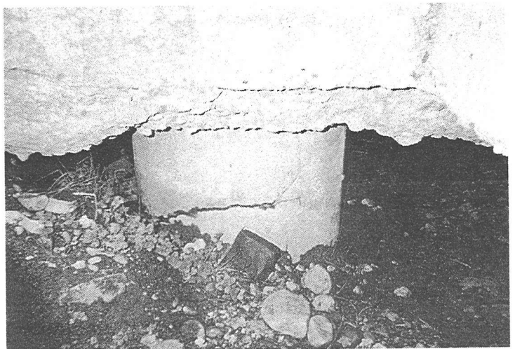
写真-1 杭頭部のひび割れ
