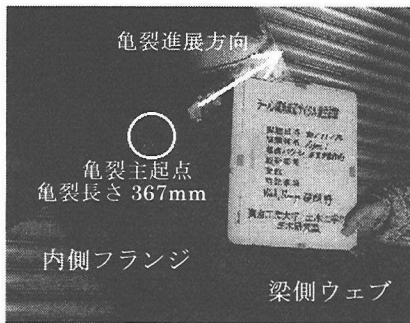
図-10 ウェブの損傷状況(試験体1)
