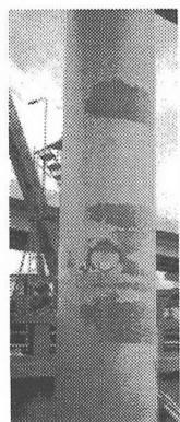
写真-1 被害状況
