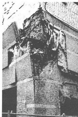
写真7 神戸地震(隅柱接合部)
