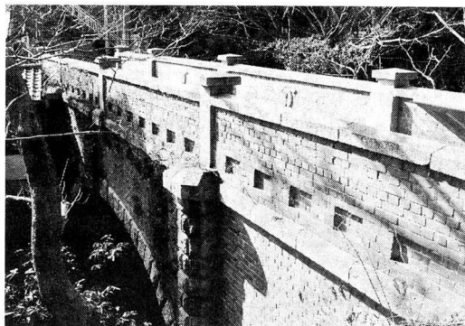
写真5 震災後の砂子橋
