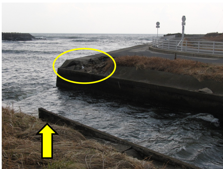
写真8 新川大橋河口の右岸護岸の状況
