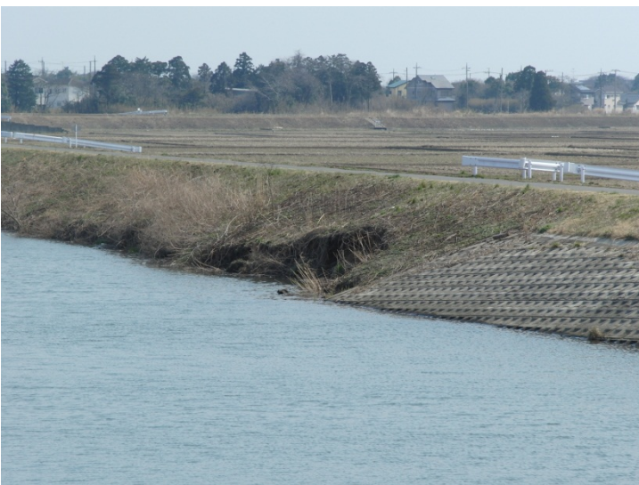
写真 28 護岸崩壊箇所の拡大写真
