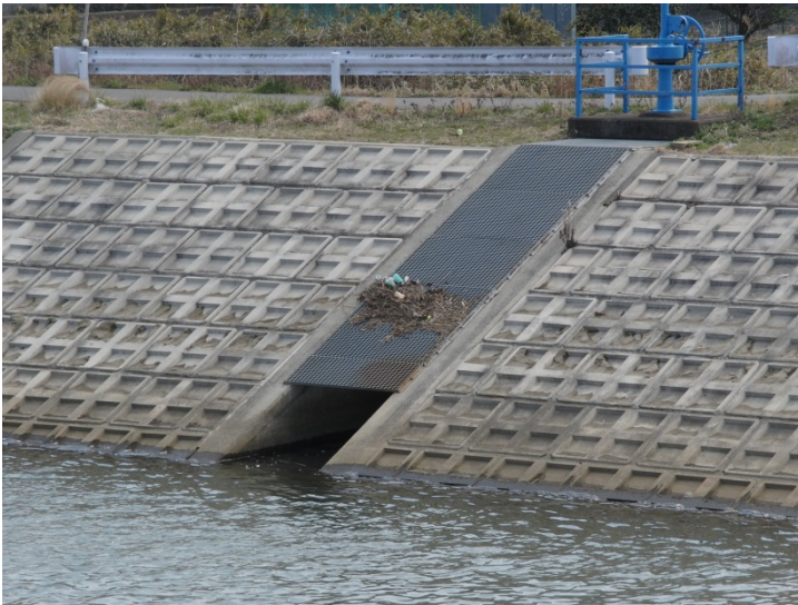
写真 26 水位痕跡部分の拡大写真
