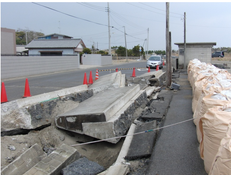
写真 15 津波により倒壊した防潮堤
