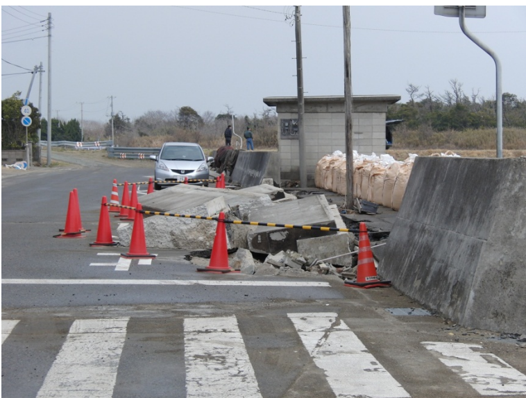
写真 16 津波により倒壊した防潮堤
