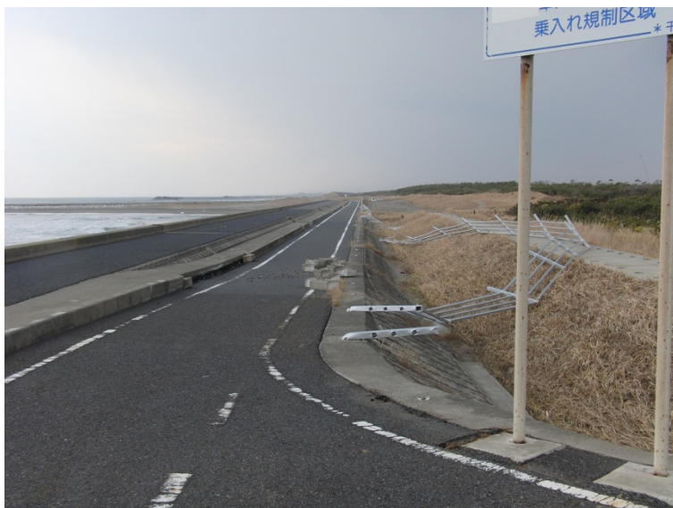
写真 4 自転車道沿いのフェンスの被災状況(写真奥が九十九里町方面(南側))
