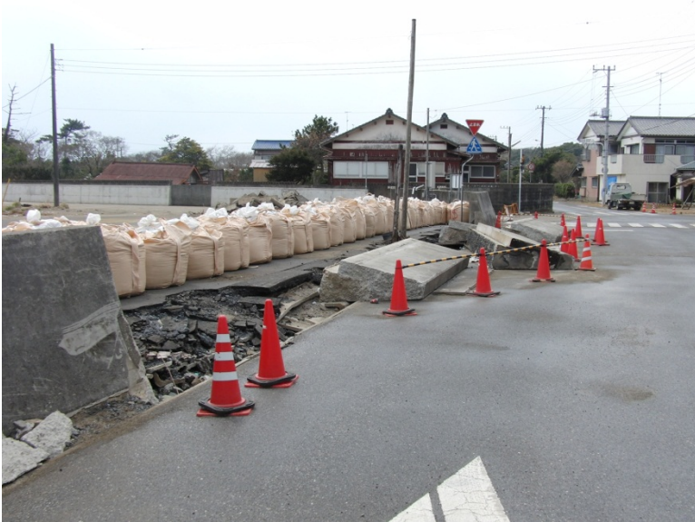
写真 14 尾形海岸の港における防潮堤被災状況
