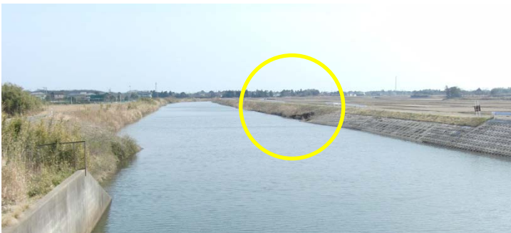
写真 27 大中堰下流右岸の護岸崩壊状況
