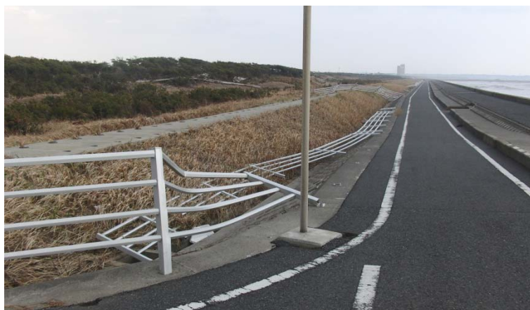
写真 5 自転車道沿いのフェンスの被災状況(写真奥が銚子方面(北側))
