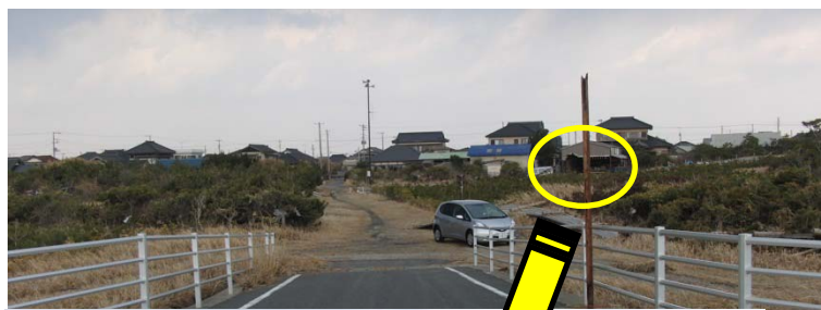
写真 6 倉庫の被災状況(自転車道路から撮影)
