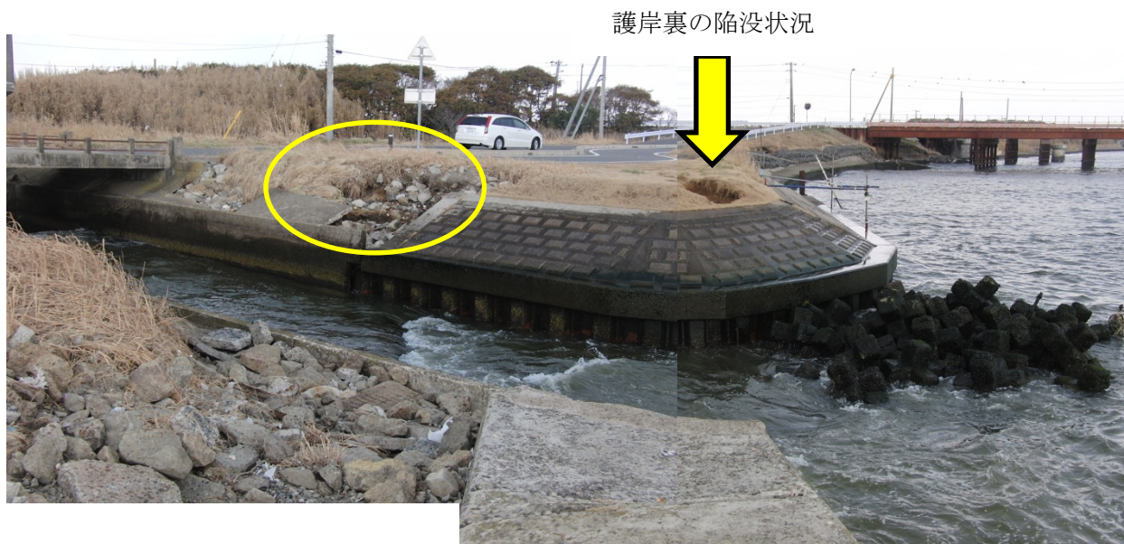
写真7 新川大橋河口の右岸護岸の状況(写真右奥の橋が新川大橋)
