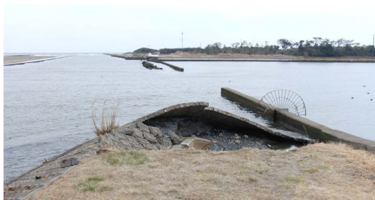
写真 11 右岸護岸先端部の被災状況(護岸天端から撮影)
