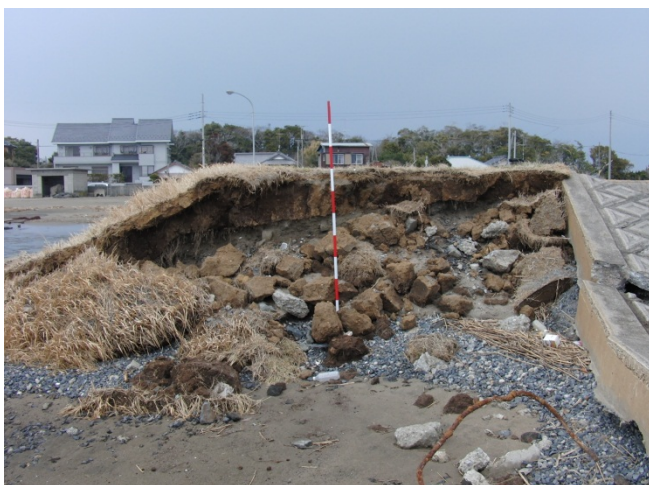
写真 12 護岸先端部の被災状況
