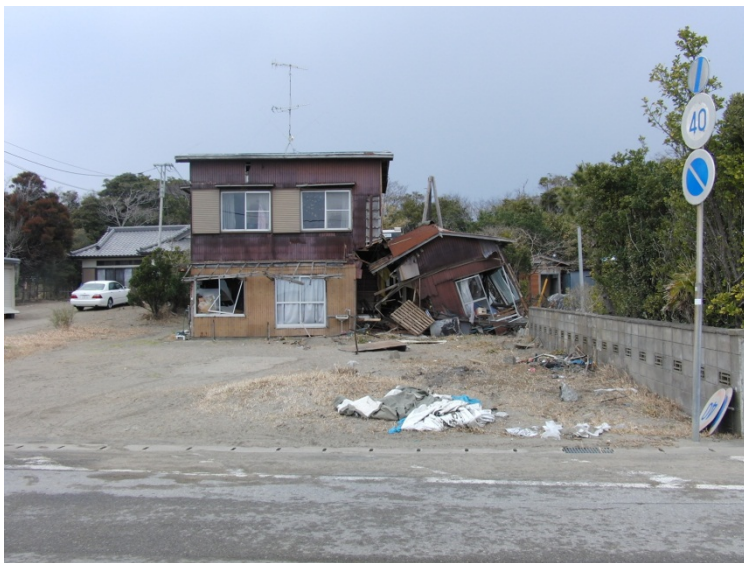
写真 21 被災した防潮堤後方の家屋
