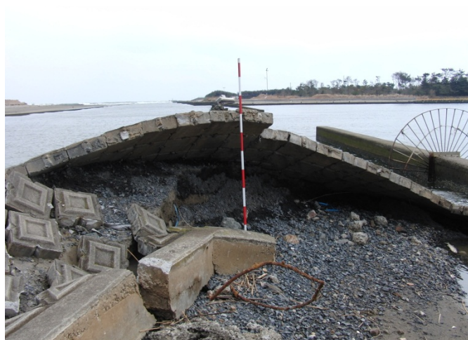
写真 13 護岸先端部の被災状況
