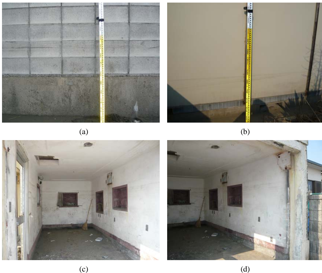
図-10 津波による痕跡
