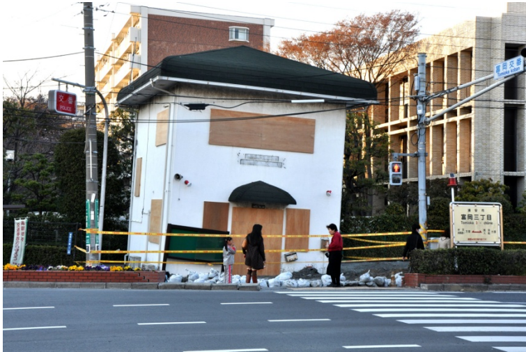
写真-12 液状化によって傾いた富岡交番（富岡3丁目）
