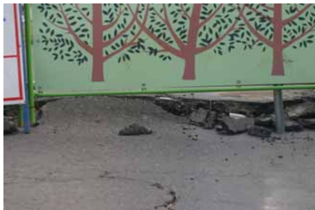
接続部の様子
