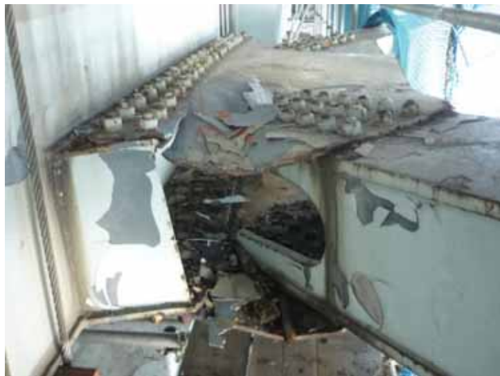
取付部材(横支材 - 下横構)の損傷
