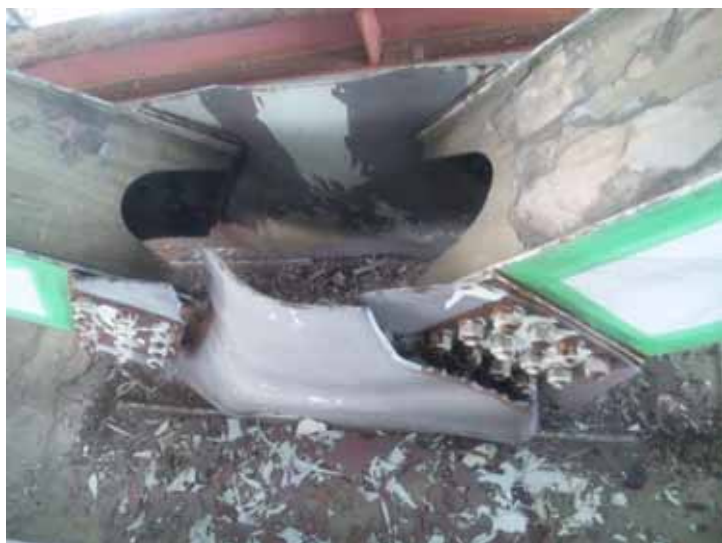
取付部材(横支材 - 対傾構)の損傷
