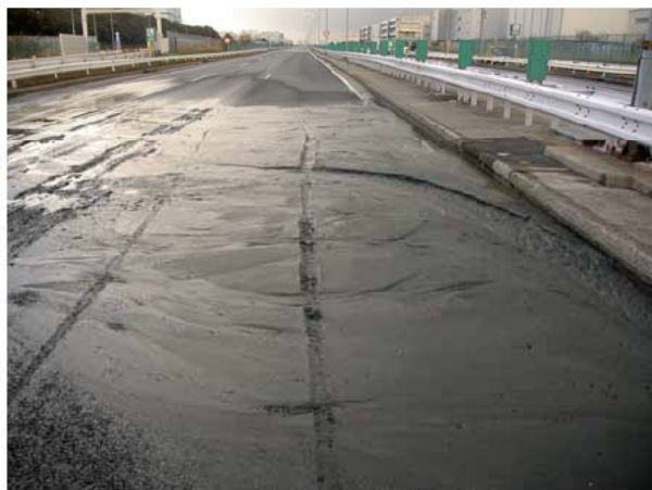
路面変状(液状化)
