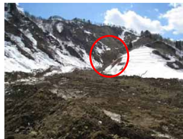
R353辰ノ口 (豊原トンネル津南側) 中央奥の斜面崩落による土石流。新潟県によると崩落 した土砂は3000 m 。土砂は国道を超えて停止。4月4日 時点で、道路から土砂は既に撤去済み。
