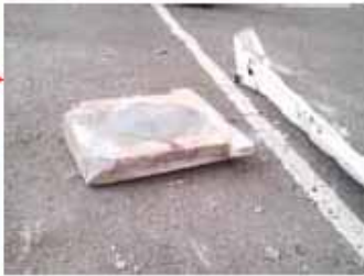
脱落した支承の一部
