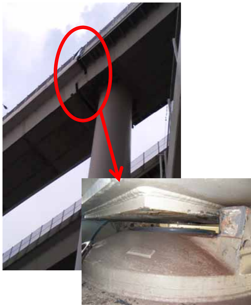
桁橋を支持する支承が脱落
