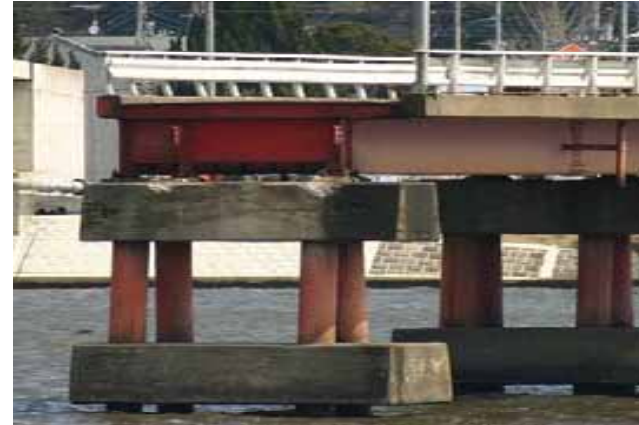
銚田市側の落橋部分
