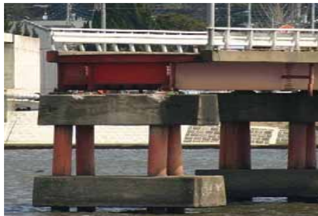
銚田市側の落橋部分
