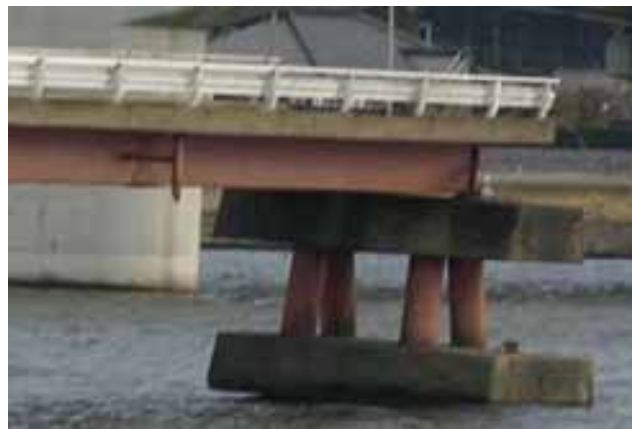
行方市側の落橋部分
