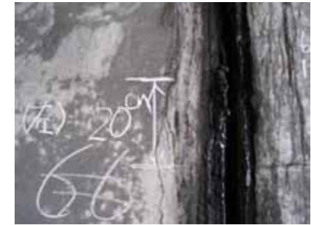
青倉トンネル津南側坑口の段差
