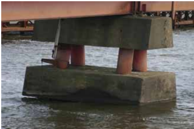
崩落していない部分
