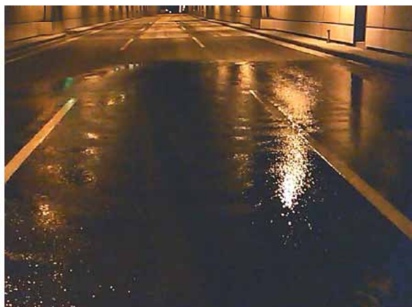
トンネル継目からの漏水
