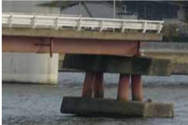
行方市側の落橋部分
