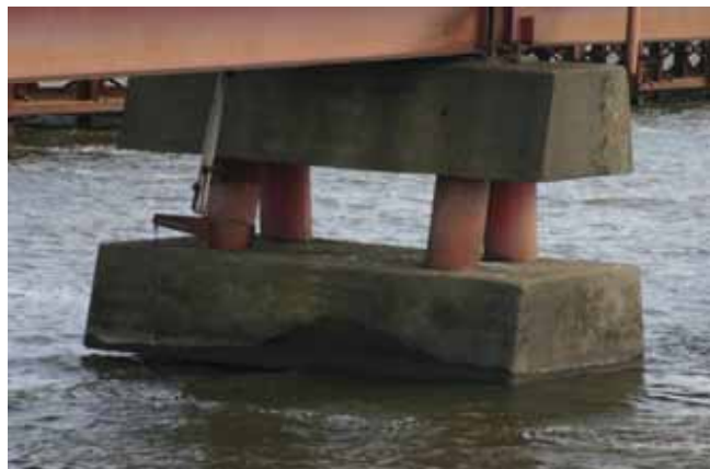
崩落していない部分
