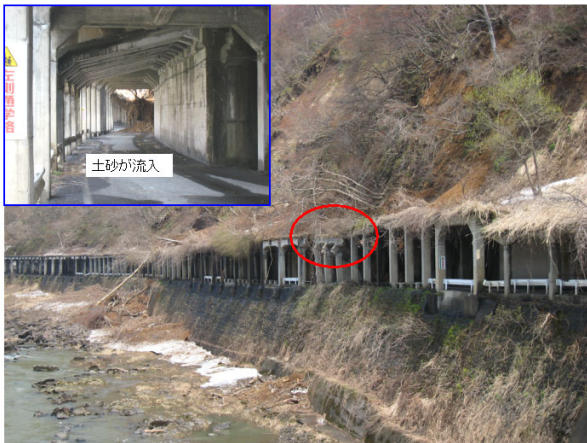
写真2.4-1 覆道の被害 (図2.4-1のNo. 1の箇所)
