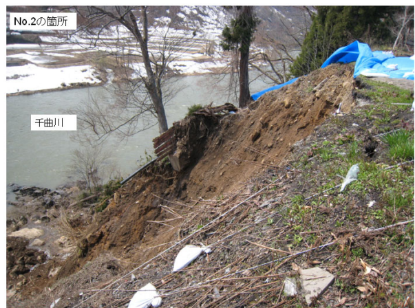
写真2. 3-3 国道117号の被害箇所（図2. 3-1のNo. 2の箇所）
