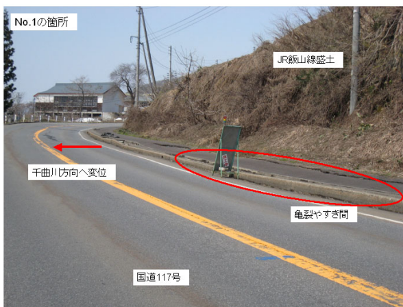
写真2. 3-1 国道117号の被害（図2. 3-1のNo. 1の箇所）
