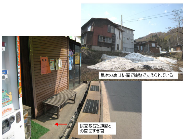
写真2.5-2 森宮野原駅周辺の被害 (図2.4-1のNo.5の箇所)
