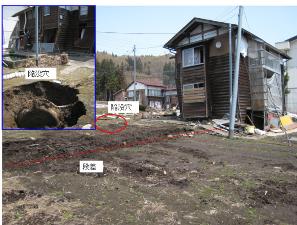
写真2.4-3 栄小学校周辺の被害 (図2.4-1のNo. 2の箇所)
