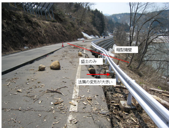
写真2.4-6 道路の被害 (図2.4-1のNo.4の箇所)
