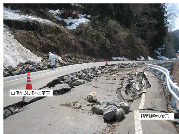
写真2.4-5 箱形擁壁の被害 (図2.4-1のNo. 4の箇所)
