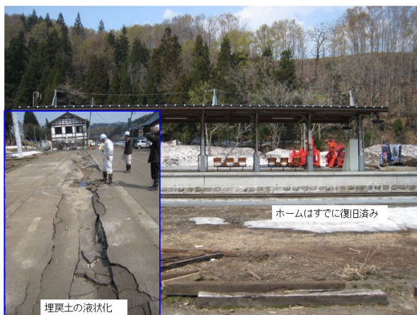
写真2.5-1 森宮野原駅の被害 (図2.4-1のNo.5の箇所)
