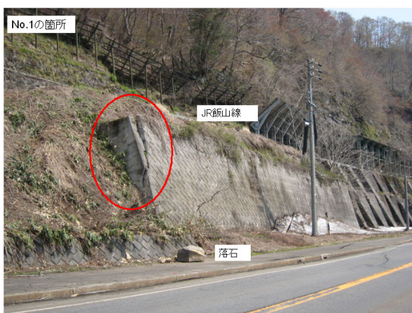
写真2. 3-2 JR飯山線の盛土の被害（図2. 3-1のNo. 1の箇所）
