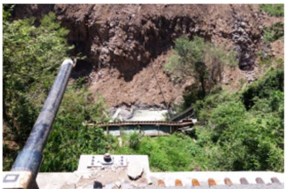
図5.2.2 落下した阿蘇大橋の橋桁
