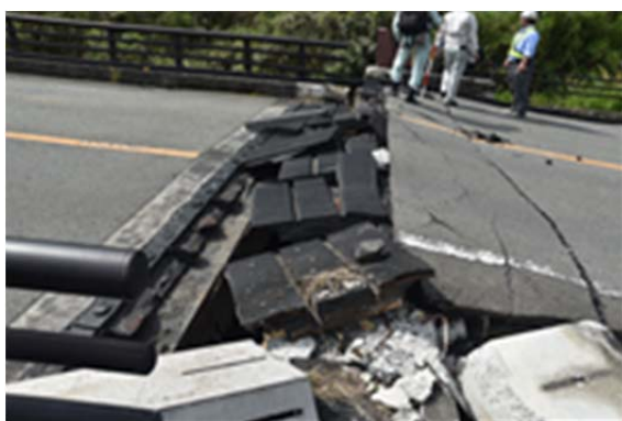
図5.2.6 桁端部の段差被害
