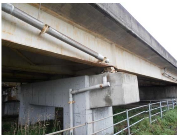
図 5.1.2 本震後の木山川橋の被害 (橋脚は RC 巻き立ての耐震補強済み)
