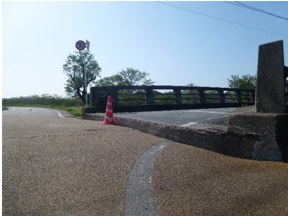
図5.2.16 宮園橋の橋台部段差被害(その1)
