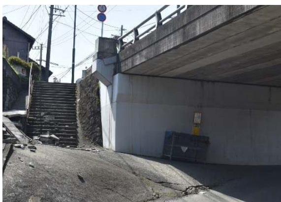
図5. 2. 22 寺迫橋の熊本側橋台部の損傷状況
