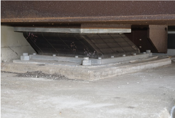
図5. 2. 39 車帰橋のゴム支承せん断変形状態
