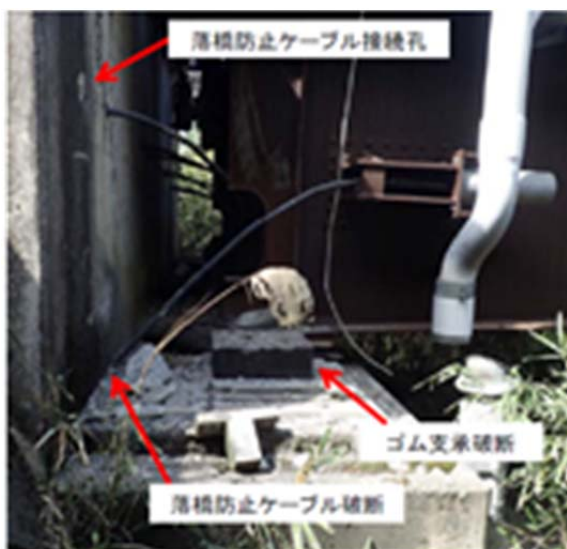
図5.2.5 大切畑大橋熊本側橋台の損傷(その2)
