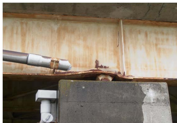
図 5.1.5 本震後の木山川橋の被害 (桁が鋼製支承から脱落)
