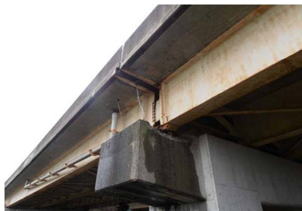
図 5.1.4 本震後の木山川橋の被害 (損傷した連結板)
