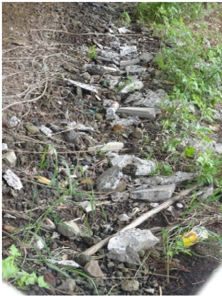
図 5.1.16 本震後の福万川橋の被害 (桁衝突で落下したコンクリート片)
