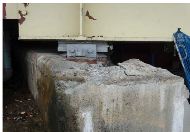
図 5.1.3 本震後の木山川橋の被害 (損傷した鋼製支承)
