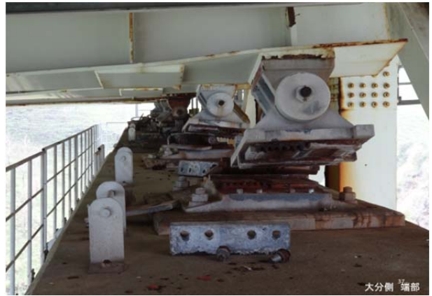
図 5.1.18 本震後の並柳橋（鉸桁橋）の被害 (桁と支承が大きく変形)
