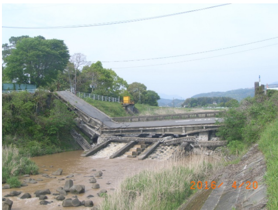
図5.2.29 震災後の田中橋
