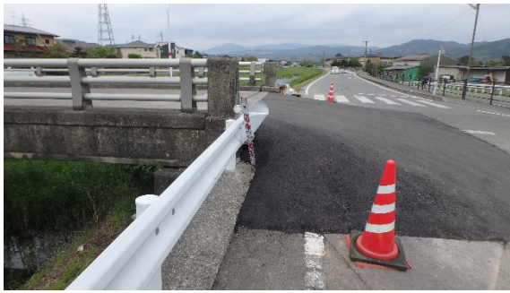
図5.2.27 福富橋道路接続部における段差被害
