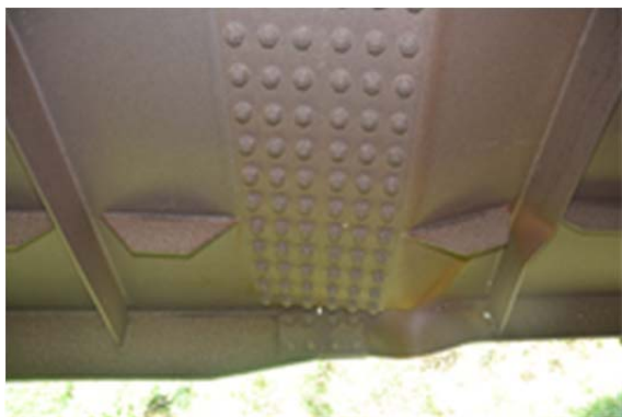
図5.2.10 俵山大橋主桁の変状
