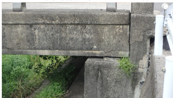
図5. 2. 26 福富橋の橋台部付近の損傷
