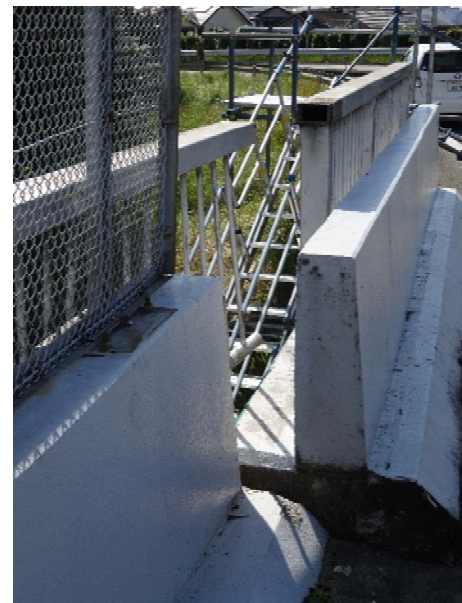
図5.1.10 本震後の東原橋の被害 (横ずれした道路との境界部)
