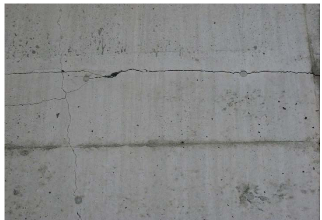
図 5.1.20 本震後の並柳橋（トラス橋）の被害 (橋台背面のクラック)
