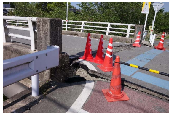
図5.2.13 木山橋 橋台部の被災状況
