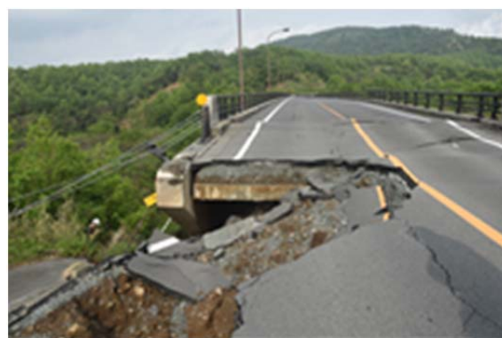
図5.2.8 俵山大橋熊本側橋台部付近
