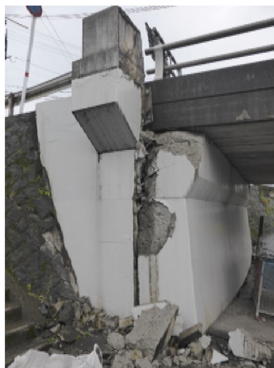
図5. 2. 23 寺迫橋熊本側橋台部の本震後の損傷
