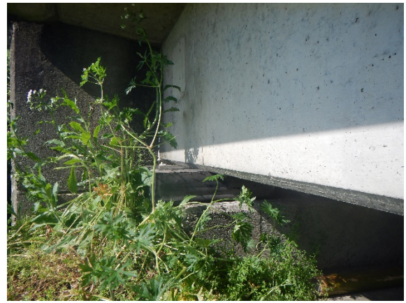
図5.2.18 宮園橋の橋台部支承付近の損傷状況
