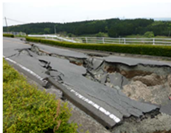
図5.2.7 盛土部の被害
