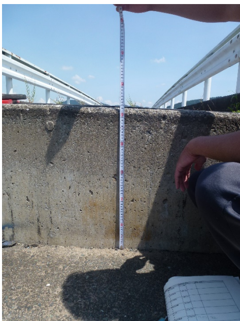
図5.2.33 第二宮園橋の橋台部段差被害(その2)
