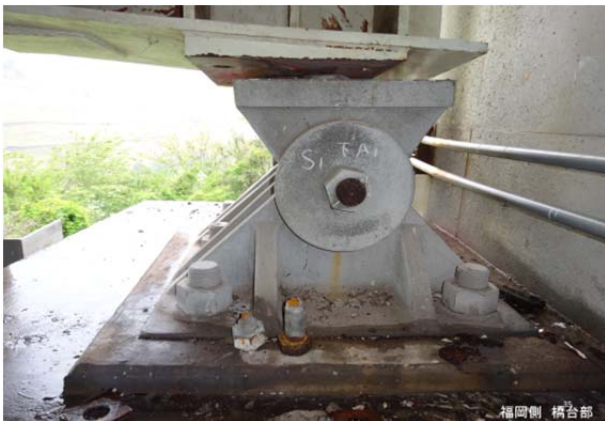
図 5.1.17 本震後の並柳橋（鉸桁橋）の被害 (損傷して桁が浮き上がった支承部)
