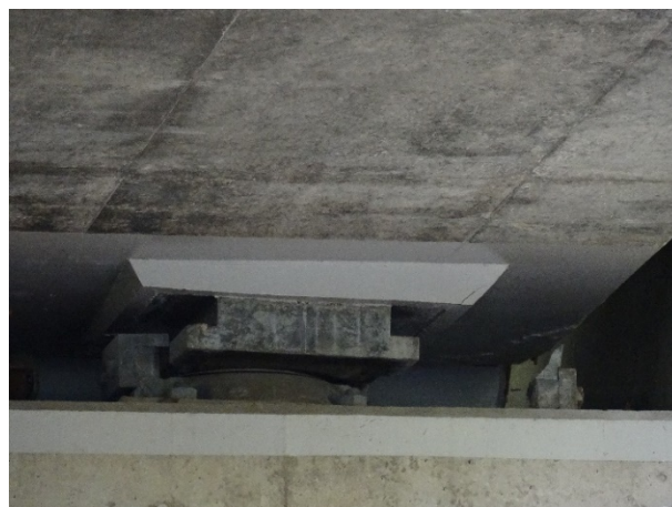
図 5.1.13 本震後の福万川橋の被害 (右側の移動制限装置が損傷)
