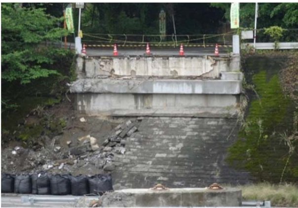
図 5.1.7 本震後の府領第一橋の被害 (橋軸直角方向に落橋)
