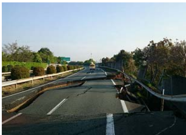
図 5.1.12 秋津川橋隣接部の盛土法面の崩落
