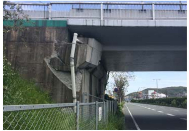
図5.1.8 本震後の東原橋の被害 (橋台部の損傷)
