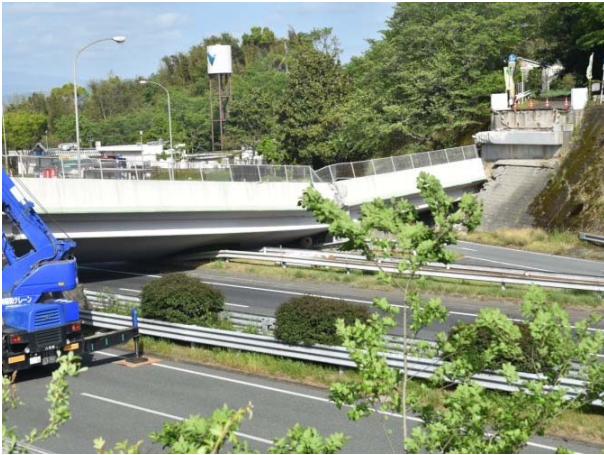
図 5.1.6 本震後の府領第一橋の被害 (橋軸直角方向に落橋)
