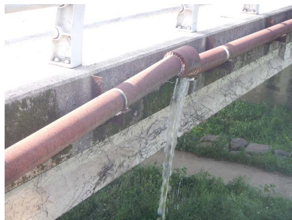
図5.2.14 木山橋の水道管被災状況
