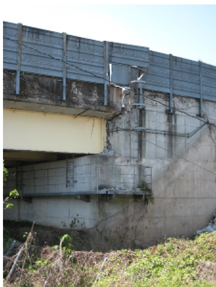
図 5.1.11 本震後の秋津川橋の被害 (桁が橋台に衝突している)
