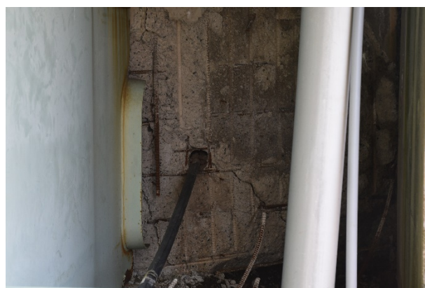
図5.2.36 大正橋の落橋防止構造の損傷
