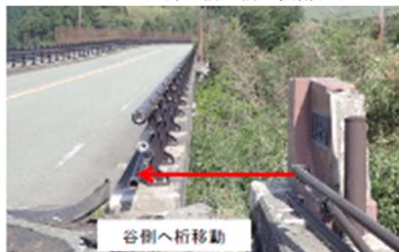
図5.2.4 大切畑大橋熊本側橋台の損傷(その1)
