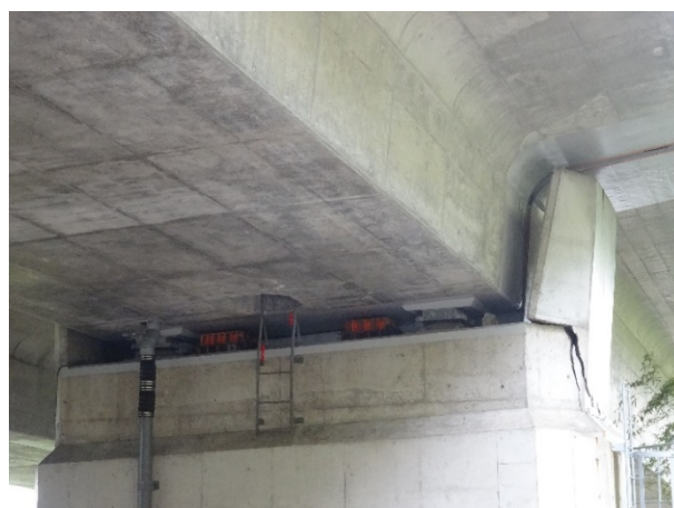
図 5.1.15 本震後の福万川橋の被害 (コンクリートの側壁にひび割れ)
