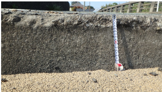
図5.2.17 宮園橋の橋台部段差被害(その2)
