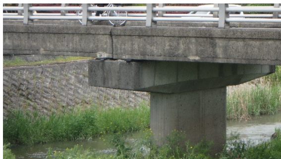
図5. 2. 25 福富橋橋脚部付近における桁のずれ
