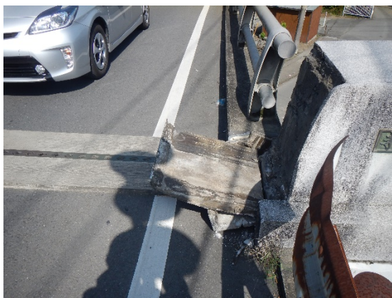
図5. 2. 21 寺迫橋の橋台接続部の被害
