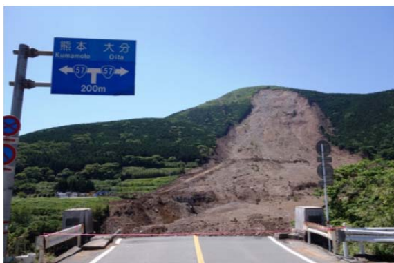
図5.2.1 斜面崩壊状況（左岸側から）
