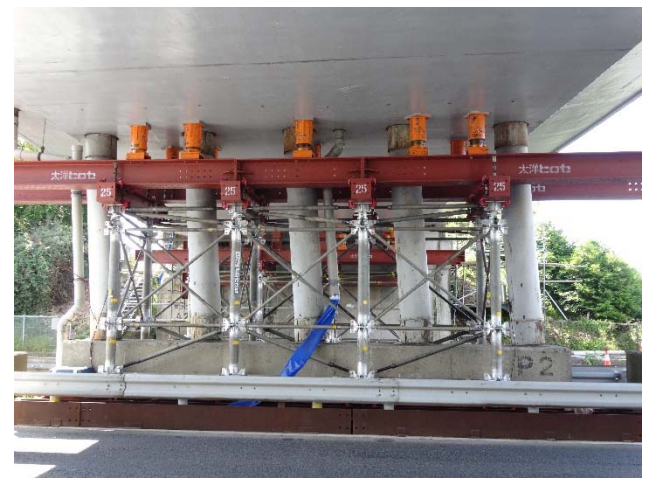
図5.1.9 本震後の東原橋の被害 (傾いたロッキングピア)
