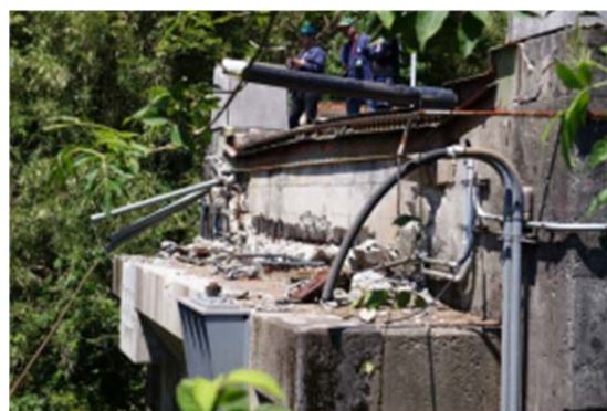
図5.2.3 阿蘇大橋の橋台損傷状況
