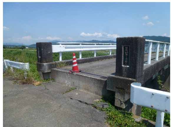
図5.2.32 第二宮園橋の橋台部段差被害(その1)
