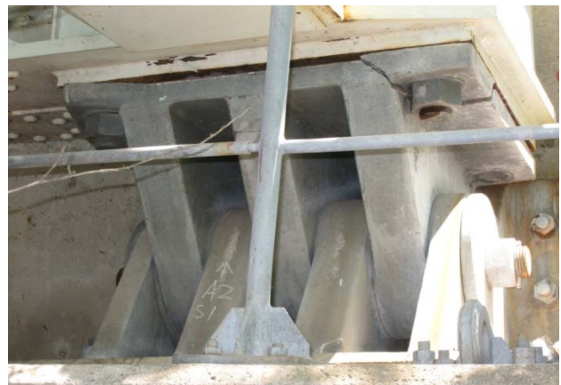
図 5.1.19 本震後の並柳橋（トラス橋）の被害 (鋼製支承と桁接合部のクラック)
