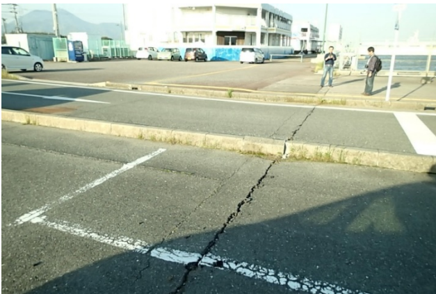
写真 6. 6. 4 熊本港湾埋立地に発生したクラック
