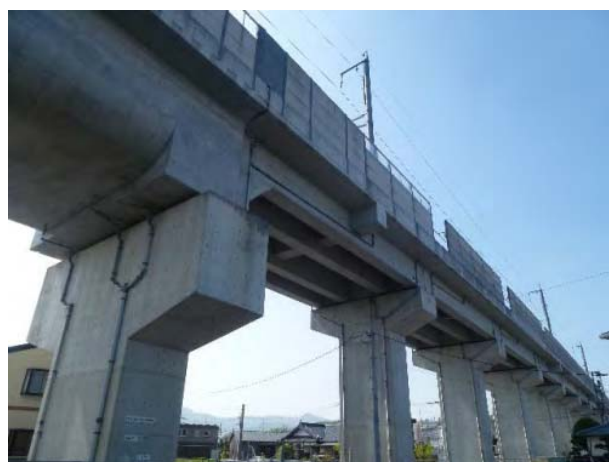
写真 6.6.2 九州新幹線の高架橋防音壁の落下
