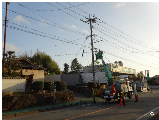
写真 6.2.1 益城町における電柱倒壊と復旧作業の様子
