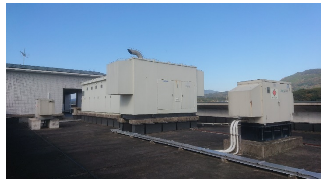
写真-2 屋上に設置した受電設備と3台の発電機
