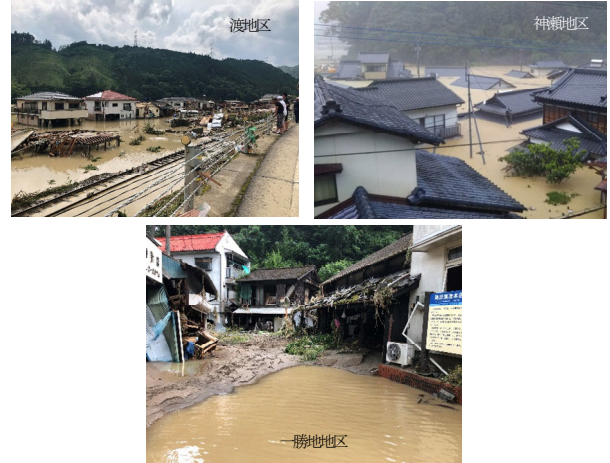
図-13 球磨村における各地域の建物被害状況の写真
