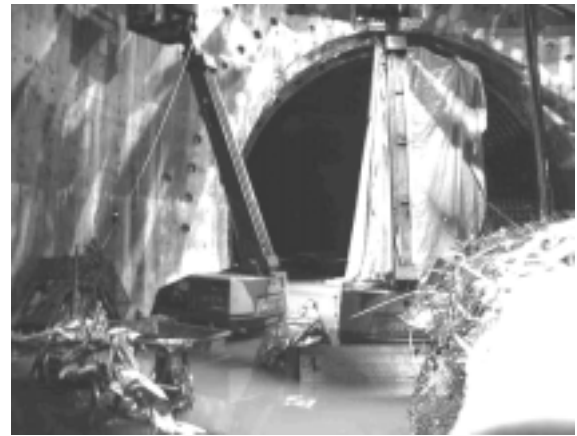
写真 - 3 水没した重機
