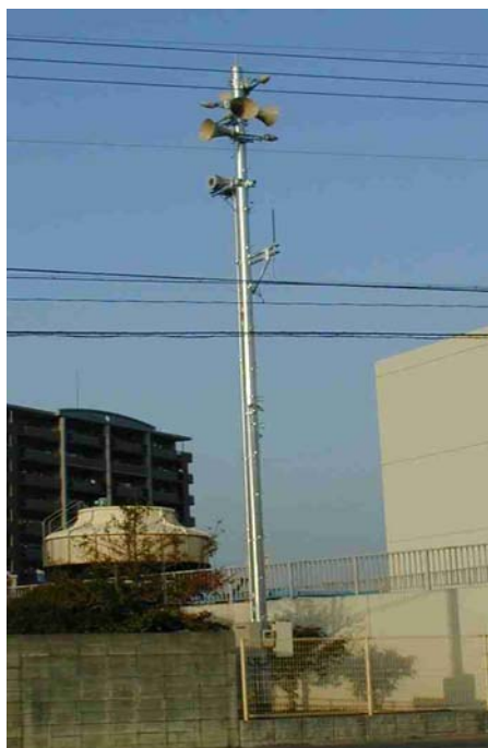
写真-3 東区原田ポンプ場に設置したサイレン
