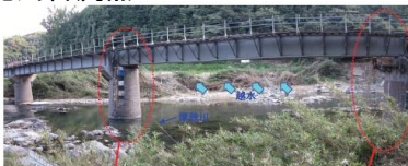
写真-13 越水の痕跡
