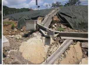
写真-11 護岸および排水路被災状況
