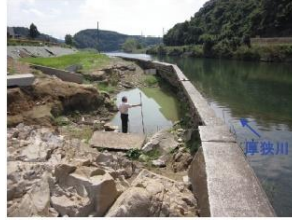
写真-10 護岸被災状況
