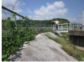
写真-10 寝太郎堰右岸の越水痕跡
