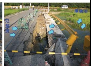
写真-16 戻り流れにより倒壊したガードレール
