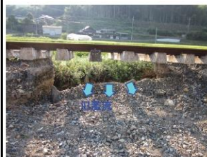
写真-15 戻り流れによる路盤の流失
