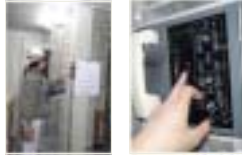
振興センター防災回線の被災状況調査
