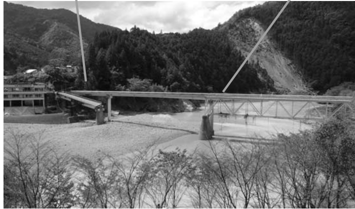
図-13 落橋した折立橋
