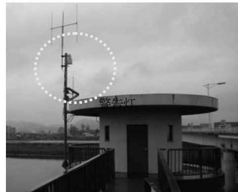
図-17 行徳水位観測所の警告灯
