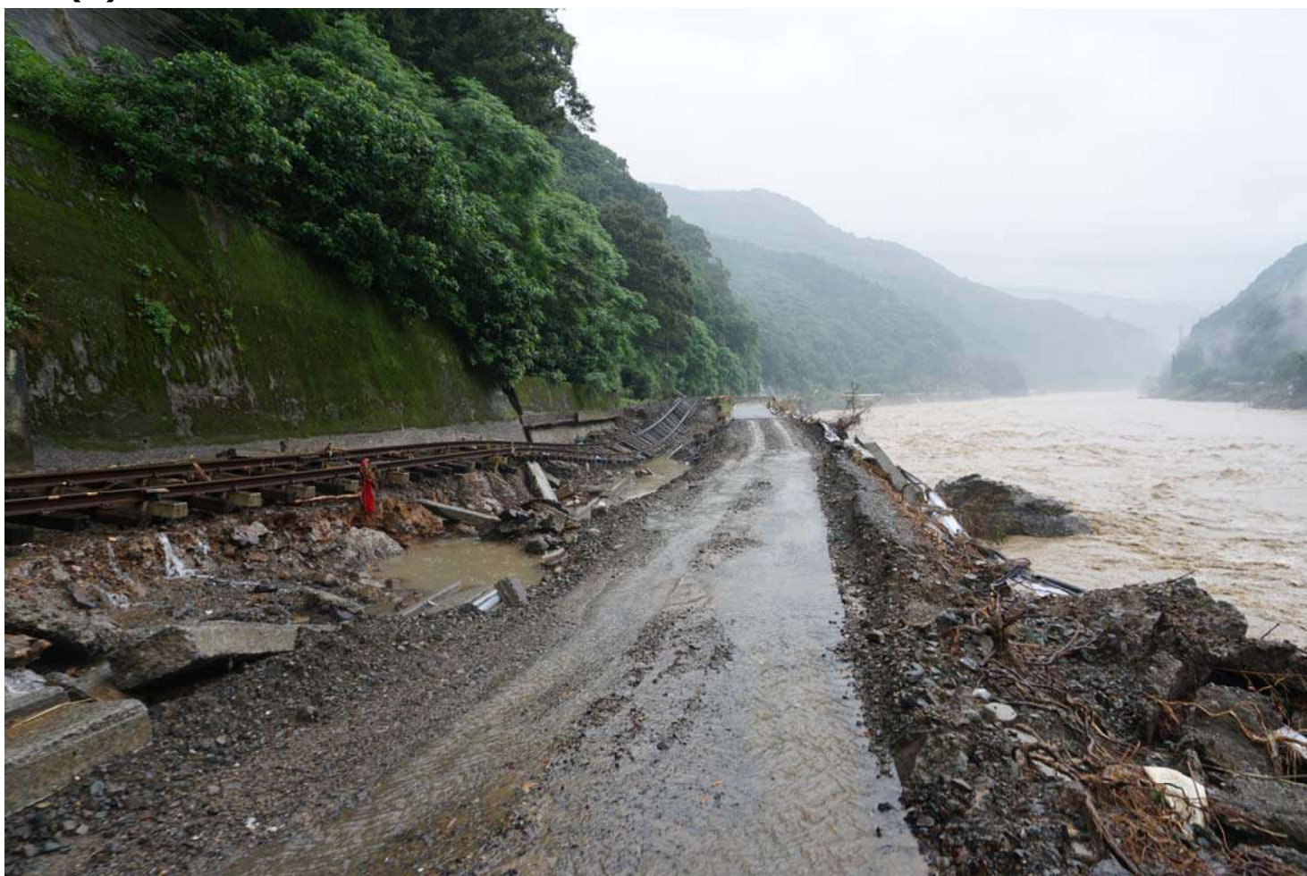
写真- 4 球磨川沿いの県道158号とJR肥薩線の崩壊（7/11撮影） 上流の鎌瀬橋も流出しこの間の集落が孤立
