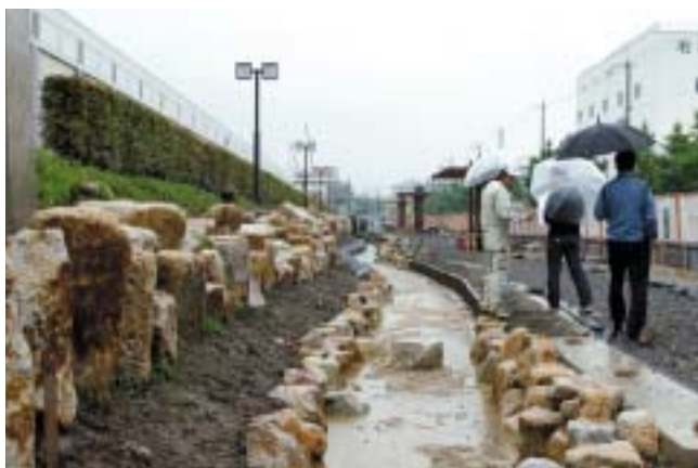
写真-8 建設中のせせらぎ水路。その横を一般市民が散策できる遊歩道が通る。奥には休憩場所提供のために作られたベンチが見える
