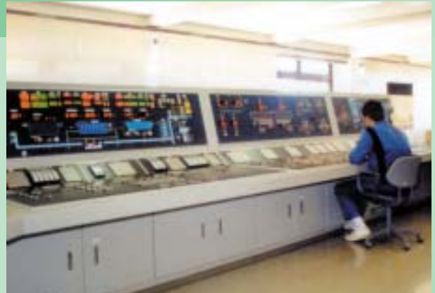
下水処理場維持管理の様子
