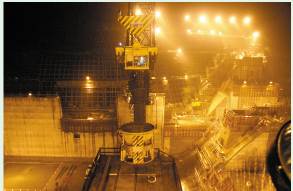
写真-7 タワークレーンによりコンクリートを現場まで移動
