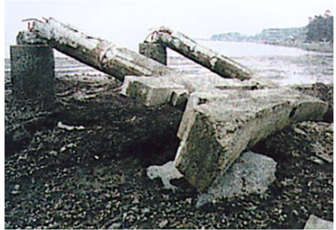
写真-2 永尾神社の鳥居の倒壊状況（熊本日日新聞9月28日夕刊掲載）
