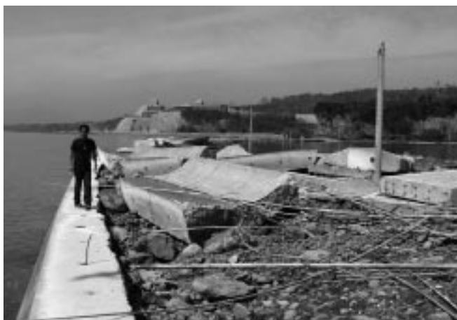
写真-5 手場地区の被災状況
