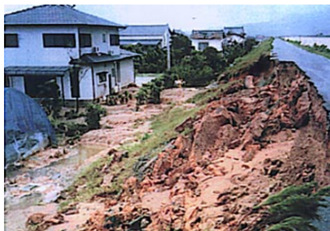
写真-6 砂川の被災状況
