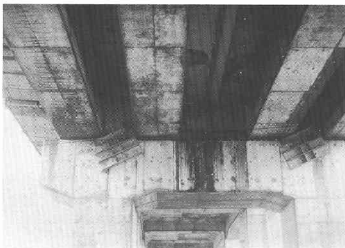
写真-9 : 桁の横移動防止器具の破損（山陽本線西宮市神呪架道橋），ボルトが破壊し移動している
