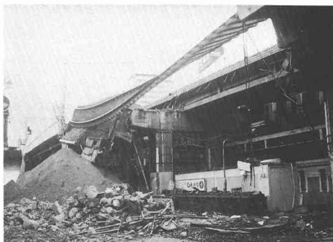
写真-10 : 桁が横移動し落下（神戸高速鉄道三宮駅付近）
