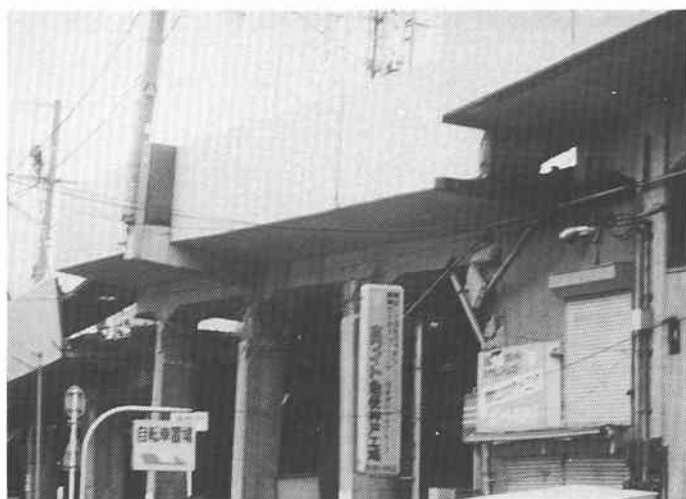
写真-5：ラーメン高架橋の破損（東海道本線六甲道駅付近），線路方向のねじれ
