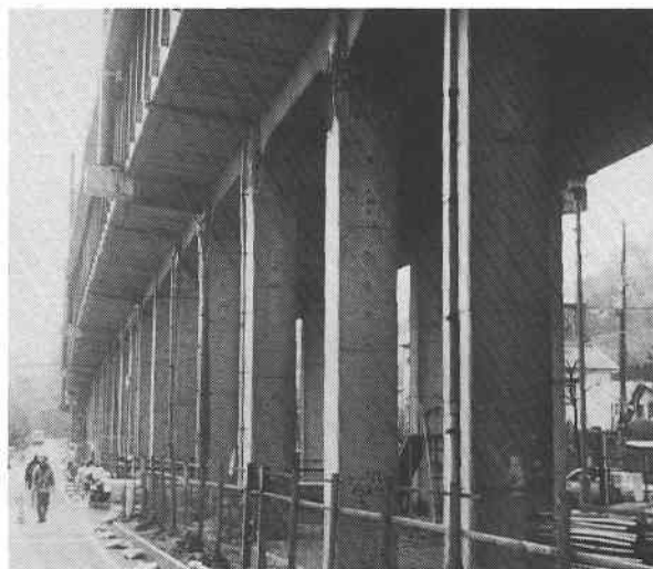
写真－2：ラーメン高架橋柱上端部の損傷、ハンチ下端
