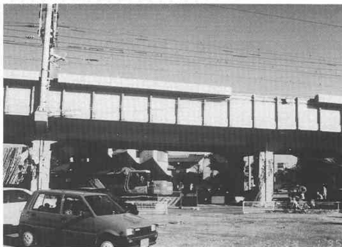
写真-4：異径間3スパンラーメン高架橋の破損（山陽新幹線西明石駅付近）
