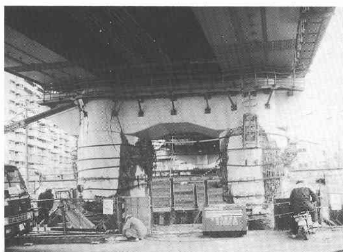
写真-14 : 第二神明線路橋橋脚の破壊，上部構造は鋼ボックス連続桁
