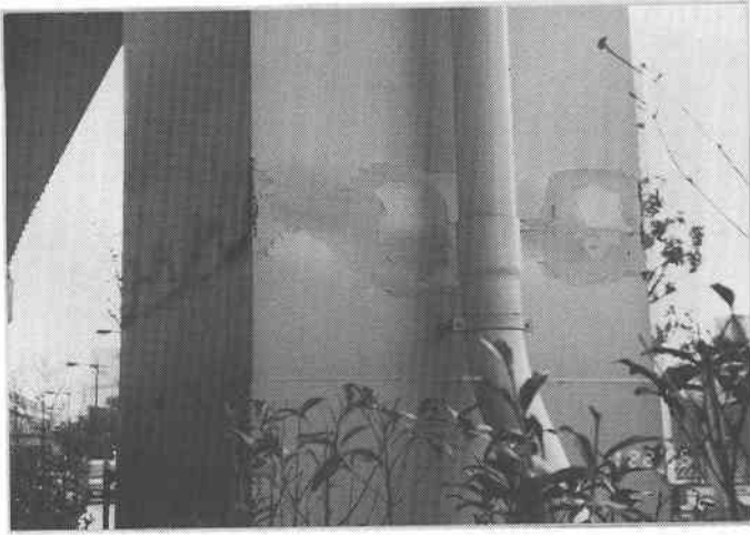
写真-7 鋼製ラーメン橋脚の局部座屈（神戸線甲子園付近）
