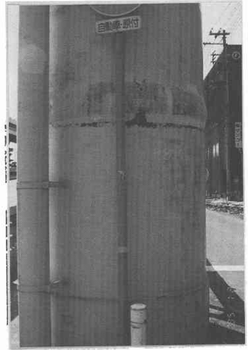
写真-8 鋼製単柱橋脚の局部座屈。ペンキのはがれている所がはらんでいるが、ほぼ全周にわたっており、ちょうちん座屈といえるもの（神戸線JR兵庫駅そばのランプ）
