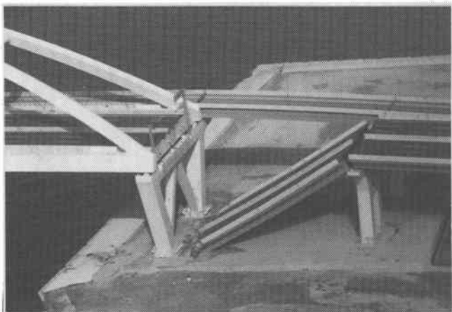
写真-12 西宮港大橋基礎の海方向への移動により 落下したアプローチ桁 (湾岸線)
