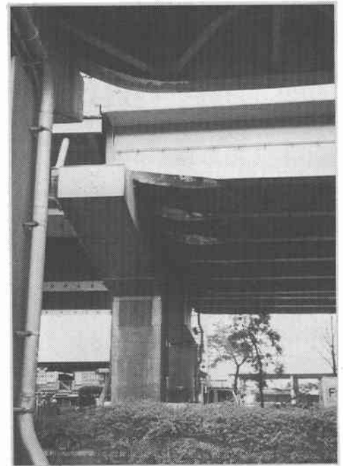
写真-10 桁の橋軸直角方向の移動により下フランジがめくれている（神戸線青木交差点付近）
