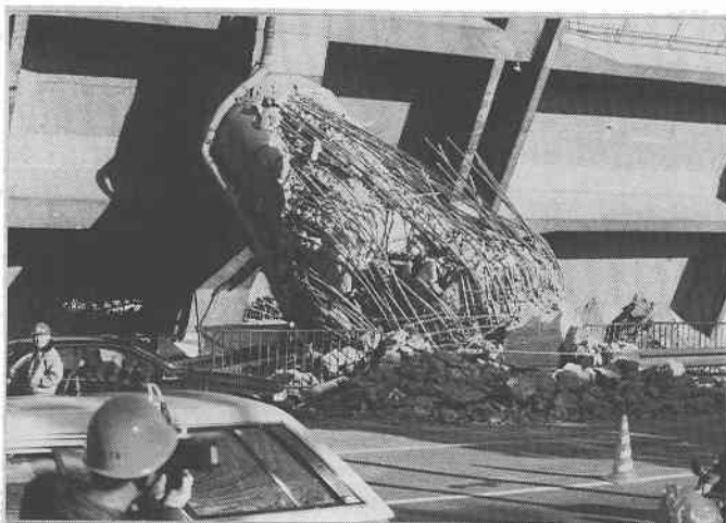
写真-5 ピルツ形式RC橋梁の倒壊 （神戸線深江地区）
