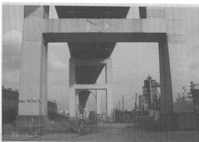
写真-16 破断したペンデル支承の下の中間橋脚、端橋脚に生じた 横ばりのせん断座屈 (湾岸線 東神戸大橋)
