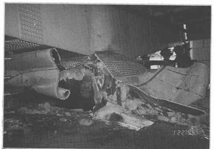
写真-6 2本のRC脚に支えられたT型鋼製橋脚の圧壊 横ばりも真ん中で折れている （神戸線西宮建石交差点付近）
