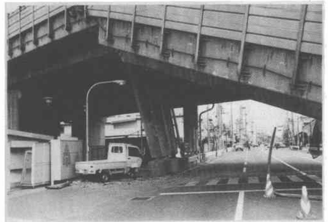
写真-21 ロッキングピアの倒壊とRCホロースラブ桁の落下 (日本道路公団、名神高速道路瓦木西)
