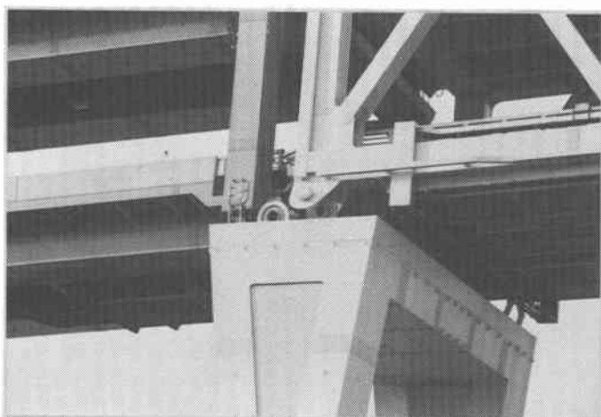
写真-14 東神戸大橋のペンデル支承 (神戸側) 受け部 (ウェブ) の破断 (湾岸線)
