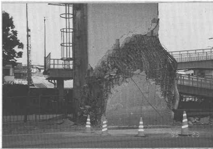
写真-1 RC橋脚のせん断破壊（神戸線）
