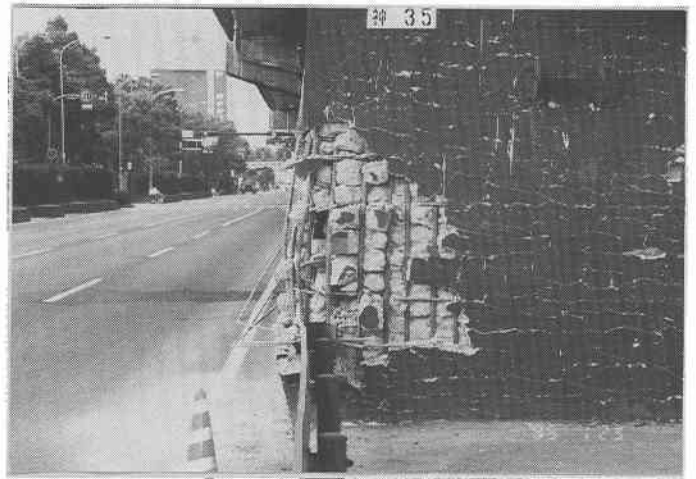
写真-2 RC橋脚基部の破壊（神戸線 甲子園付近）
