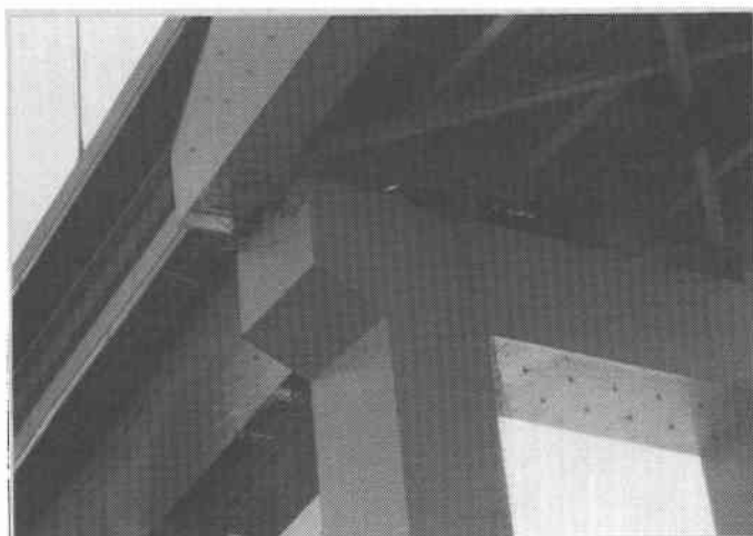
写真-17 落橋寸前の橋桁 (湾岸線 六甲アイランド橋)
