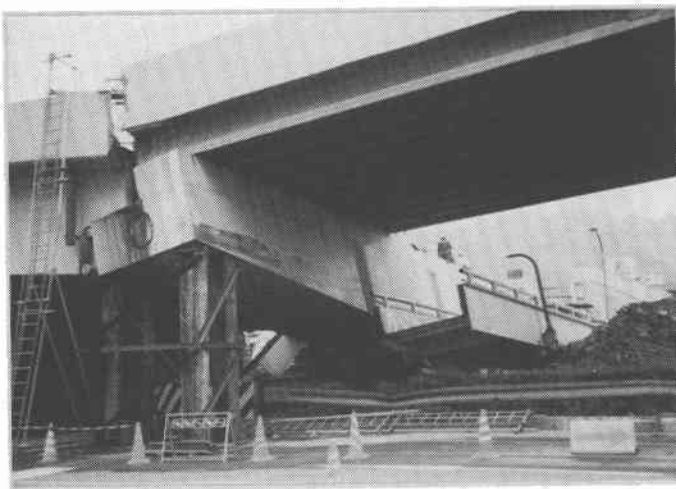
写真-22 鋼製T型橋脚の圧壊 前後(東西)の北側のRCT型橋脚は倒壊している (国道43号線の国道2号線との立体交差 神戸市岩屋)
