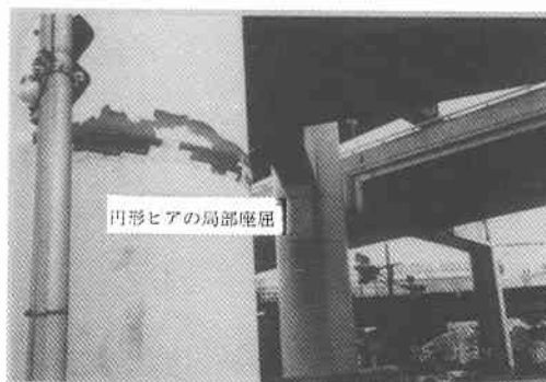
写真16 港湾幹線道路合流部での円形断面鋼脚柱の局部座屈
