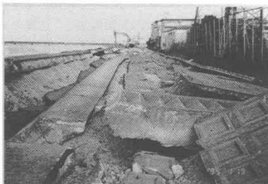
写真23 淀川下流左岸における堤防の崩壊状況
