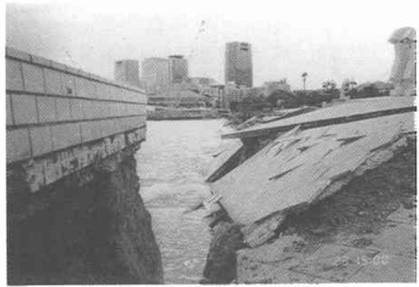
写真2 崩壊した中突堤
