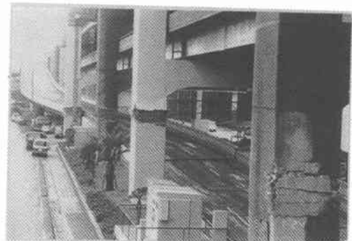
写真15 神戸大橋へのアプローチ部の鉄筋コンクリート製ラーメン橋脚の破壊
