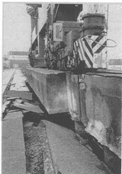
写真9 沈下した北ふ頭
