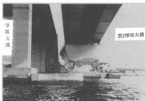
写真19 第2摩耶大橋鉄筋コンクリート製橋脚の破壊
