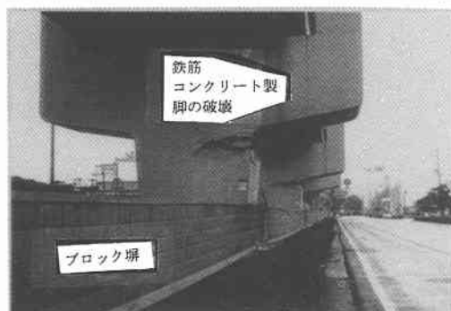
写真17 港湾幹線道路鉄筋コンクリート製橋脚の破壊
