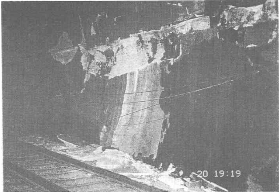
写真 3. 1. 2(538km870m 付近) 左側壁圧ざ(六甲トンネル)
