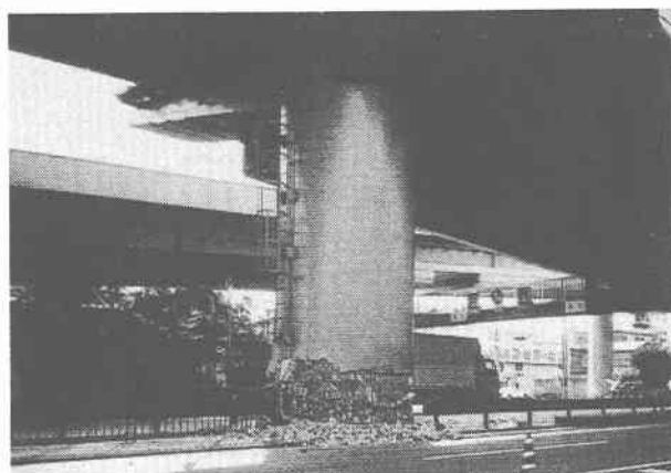
写真5.3.1 RC製丸単柱橋脚の曲げ破壊状況
