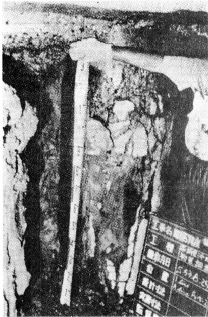
写真7 ①-④ フーチングの No. 1 ぐいの破損状 況（仙台市提供）
