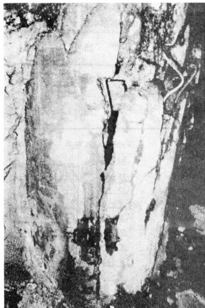
写真8 ①-④ フーチングの No. 2 ぐいの破損状 況（仙台市提供）
