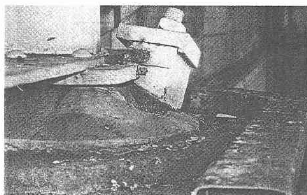
沓の被害 (サイドブロックの破損)
