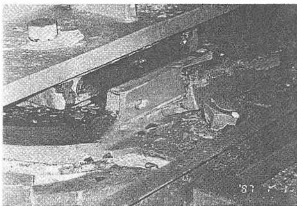
支承板支承の上沓移動制限装置の損傷状況
