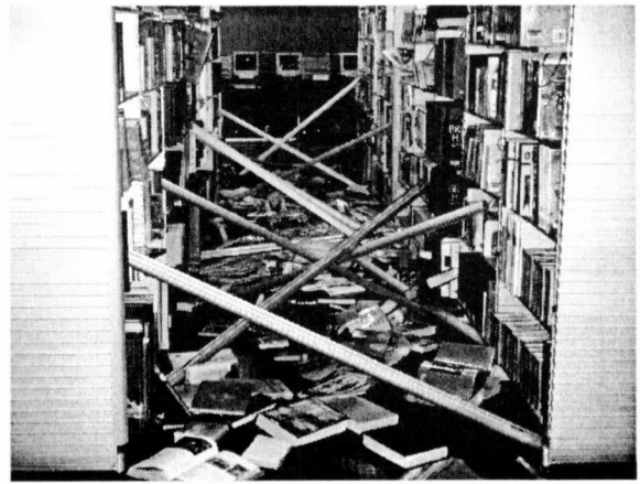
写真10 書籍の落下と書架枠の外れ (日本建築学会東北支部災害調査委員会)
