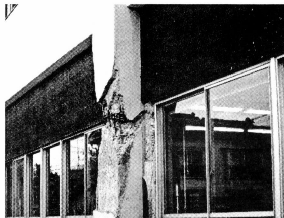
写真4 本館裏側の柱のせん断破壊 (国土交通省調査団資料より抜粋)
