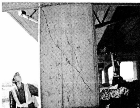
写真-3 中間柱の斜めひび割れ
