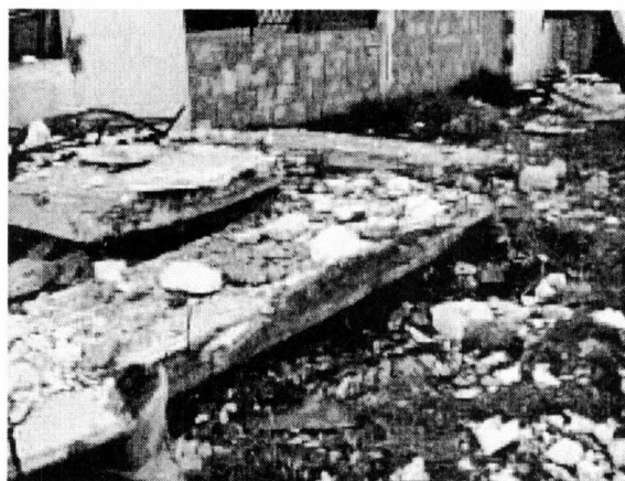
写真 2 2 落下した PC パネル
