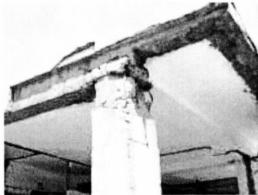
写真18 柱の打ち継ぎ部の被害
