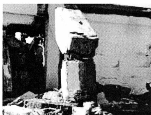
写真10 柱の破壊（主筋の破断）
