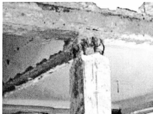
写真6 柱端部の破壊
