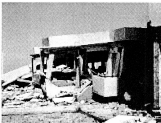
写真7 大破した建物
