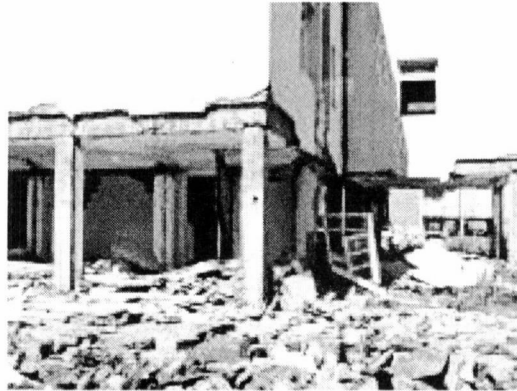
写真2 1階の煉瓦壁の崩落
