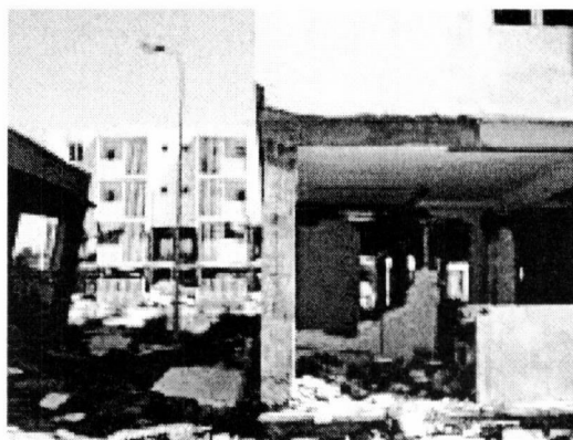
写真8 柱端部の破壊
