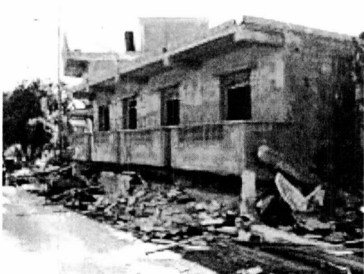
写真11 ピロティ階の崩壊
