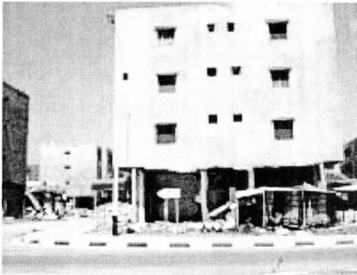
写真1 1階の煉瓦壁の崩落
