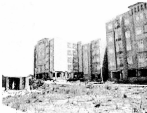
写真14 比較的新しい公共住宅の被害
