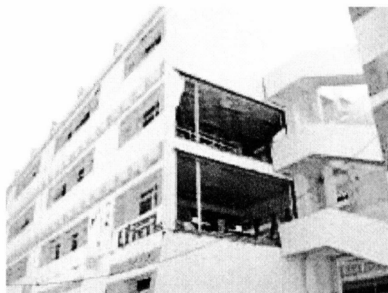
写真 2 4 壊れ落ちた煉瓦の外壁
