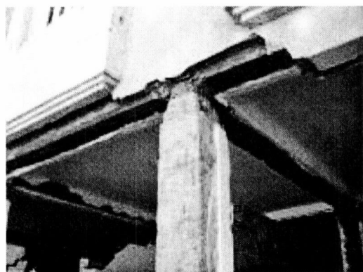
写真17 柱の打ち継ぎ部の被害
