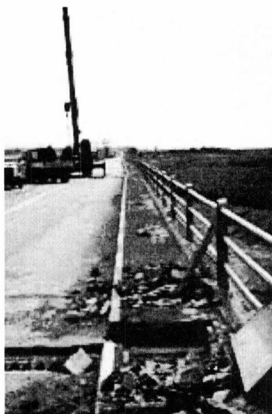
写真1 桁の水平変位と継目の破損
