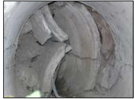
図-4 橋台側面部のヒューム管の損傷
